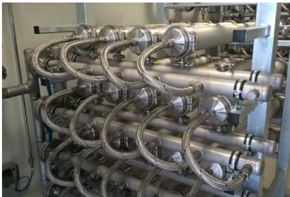
Installazione Bright Biomethane con moduli a membrana
