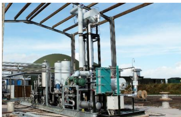
Liquefazione CO 2 , Hereford (850 kg/h)
