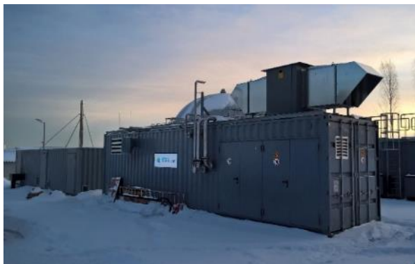
Installazione Bright Biomethane di Härnösand (100 Nm 3 /h)
