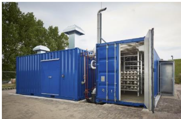
Installazione Bright Biomethane di Waalwijk (850 Nm 3 /h)
