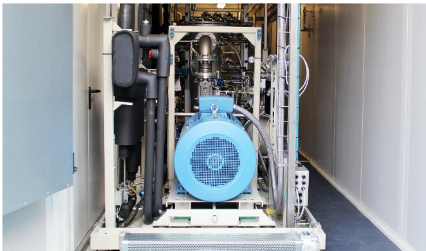
Compressore a vite per biogas
