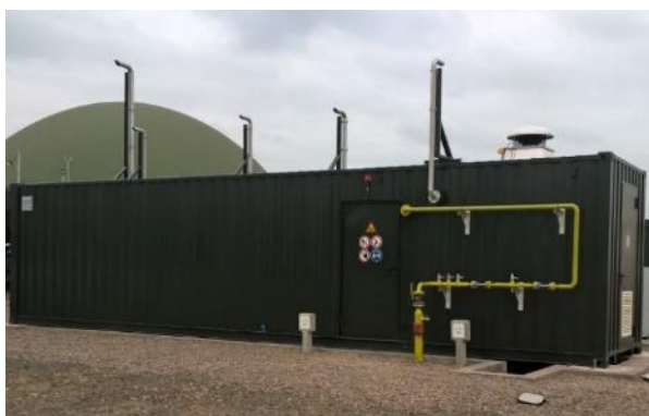
Installazione Bright Biomethane di Hereford (1000 Nm 3 /h)
