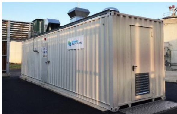
Installazione Bright Biomethane di Tours (200Nm 3 /h)
